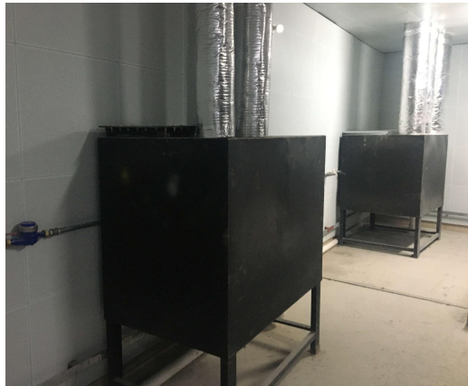
发电机尾气喷淋装置
