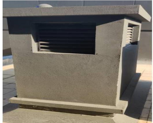
位于楼顶的发电机尾气排放口
